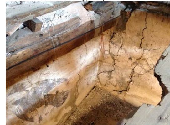
Fig. 2. Le decorazioni pittoriche nell'angolo opposto al precedente.; si notano le lesioni murarie che hanno danneggiato i dipinti
