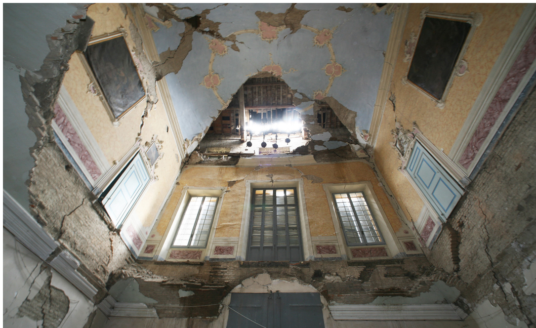
3. Interno del palazzo che documenta la gravità dei danni prodotti dal sisma del 2012.
